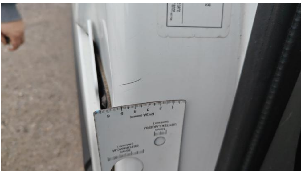
Fot. 82. Słupek (B) P - zarysowanie 1
