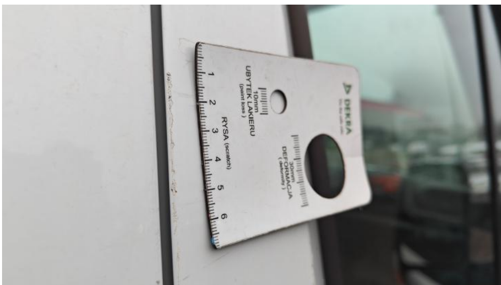
Fot. 72. Drzwi P P - zarysowanie 1
