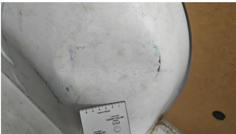
Fot. 48. Ściana boczna TP - wgniecenie 1
