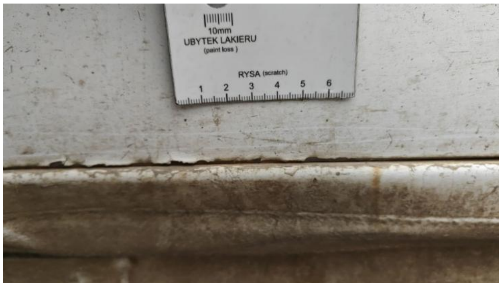
Fot. 75. Drzwi T P - korozja 1
