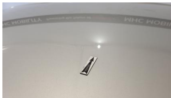
Fot. 48 Dach - Wgniecenie/odkształcenie 1
